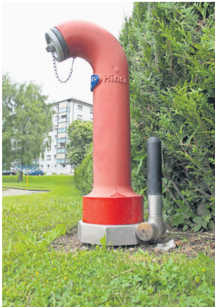
A Moudon des «hydrophones» traquent les fuites du réseau. Au pied de cette hydrante, l'antenne qui relaie l'alarme. C. AEBI
